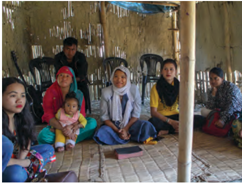
Le bâtiment en terre battue de l'église BIC dans le district d'Itahari Sunsari a été endommagé par les inondations.
